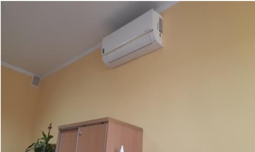
Klimatyzacja w budynku Urzędu Miejskiego w Brzostku
