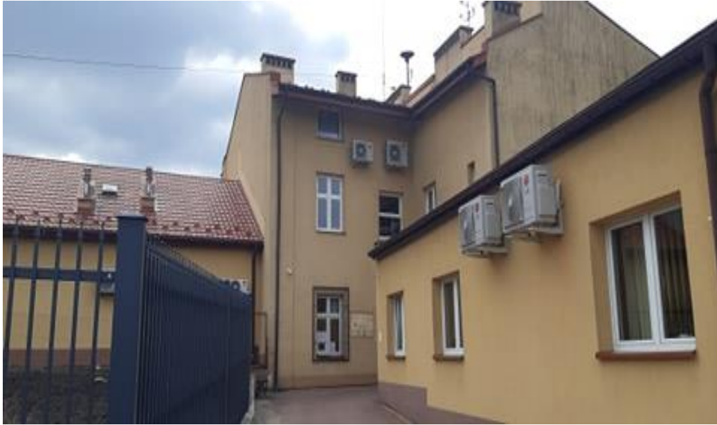
Klimatyzacja w budynku Urzędu Miejskiego w Brzostku
