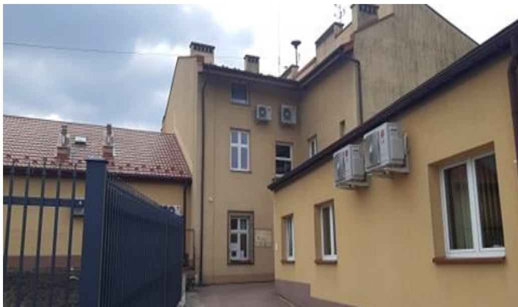
Klimatyzacja w budynku Urzędu Miejskiego w Brzostku
