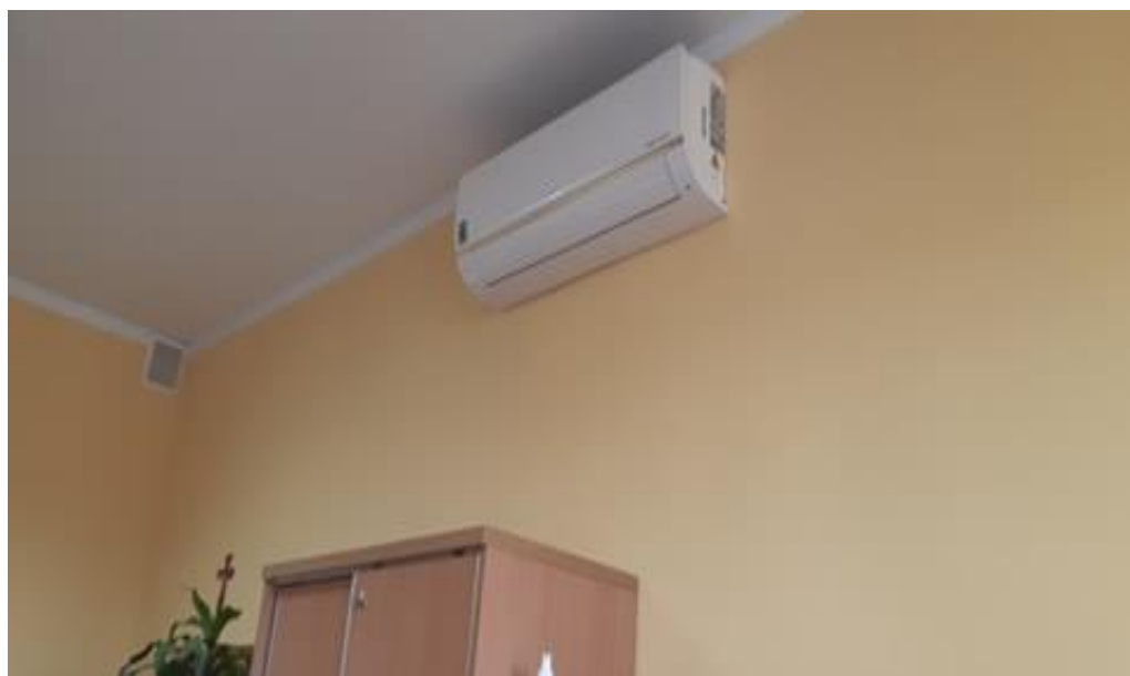
Klimatyzacja w budynku Urzędu Miejskiego w Brzostku
