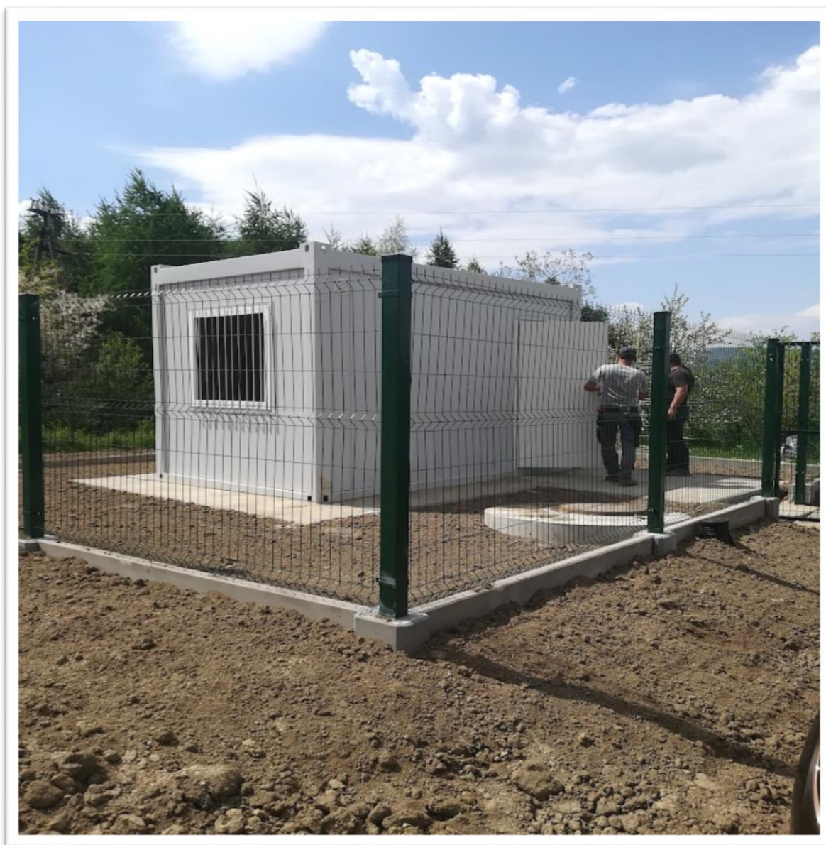
Hydrofornia kontenerowa w Bukowej
